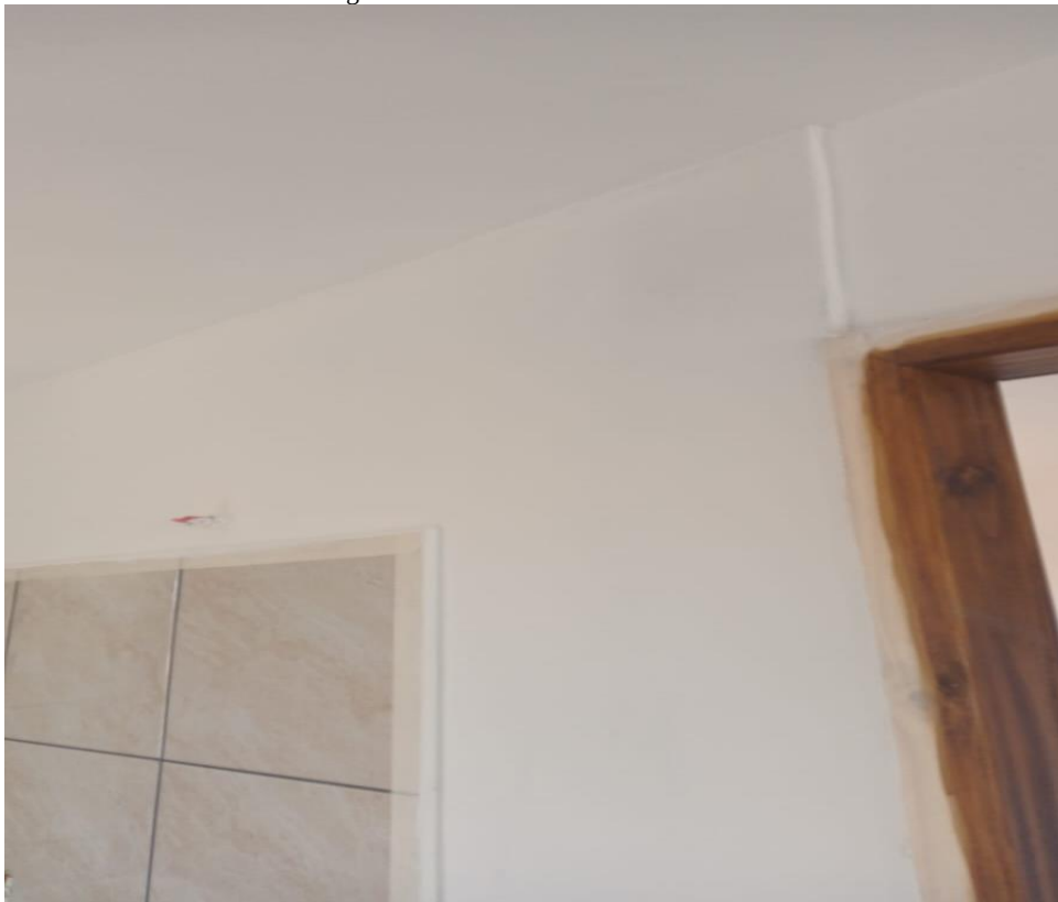
Imagem 2. Gesso com reboco convencional
